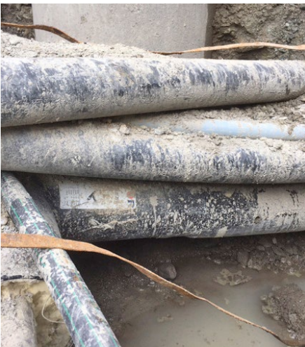
Fehlende Hinterfüllung von Werkleitungen
