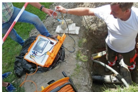
Einsatz Messeinrichtung für Fehlersuche
